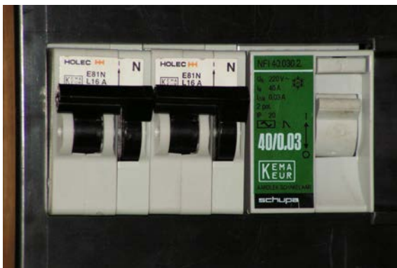
Bild 8: Dieser »Aardlek-Schakelaar« in einem niederländischen Ferienhaus kann Ströme bis 40 A abschalten – und das tut er spätestens dann, wenn zwischen Hinweg und Rückweg des Stroms eine Differenz von 0,03 A auftritt
