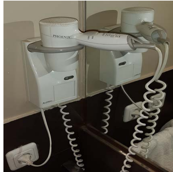
Bild 7: So nicht! Gefunden in einem Hotel in Deutschland 2020: Der Halter für den Föhn ist über einen Euro-Stecker angeschlossen, der durch den Föhn um ein Mehrfaches überlastet wird, und wenn dieser Föhn ins Wasser fällt, löst kein Fi-Schalter aus – unverantwortlich!
