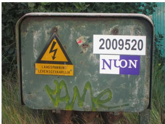
Bild 2: Niederspannung, Low voltage, Tension basse, Laagspanning – das klingt alles so niedrig, reicht aber fachsprachlich bis 1000 V Wechselfspannung oder 1500 V Gleichspannung!
