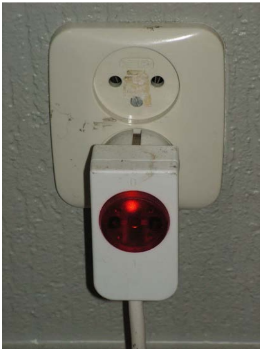
Bild 4: Vorgefunden in einem Ferienhaus in den Niederlanden 2012: Steckdose der Schutzklasse II, darin ein Verbrauchsmittel der Schutzklasse I – aber der Schutzkontakt des Steckers hängt dann in der Luft: Unverantwortlich!
